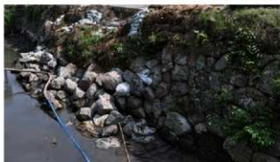
龍岡城跡石垣崩落状況
