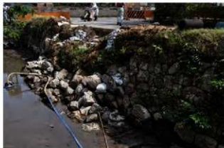
崩壊した北後堡の堀外側石垣
