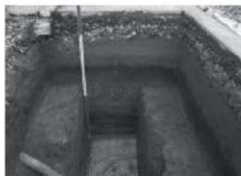
A. 獣医学研究科支障配管切り直し(排水管等)工事 TP01 西壁 1605
