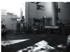
F. 福利厚生会館ボイラーブロー配管修理工事 (西より) 1610
