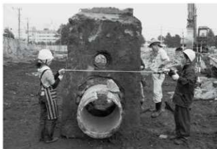
排水枡（F区）
