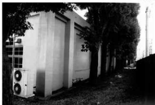
6 電気室を北隅より見る
