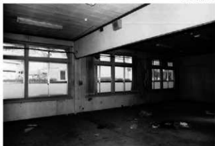
31 同29 南東の窓側を見る 床、天井とも創建時の板張りが残る
