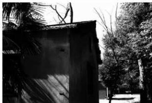
9 破風板、雨樋の消失
