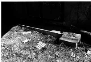
15 入口手前の階段 本来は2段だが下段は土に埋もれている
