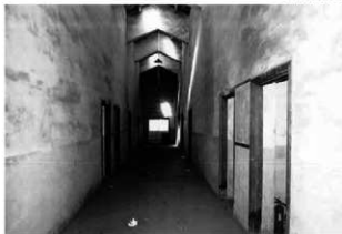
9 内部中廊下 コンクリート製の登り梁がむき出しの状態
