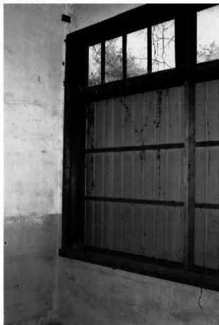
16 窓は引き違い 建具は消失
