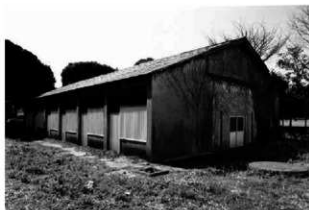
4 東側から見た全景 風除室は失われ、破風板も損傷している 木製窓は金属製パネルで覆われている
