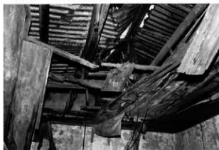
16 屋根の鉄板はモヤに直接葺かれている
