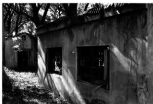
11 南東面 かなり枯葉に埋もれている
