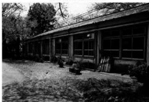
3 南東面を北側から見る 創建時は爆風除けの 土壁が造られていた
