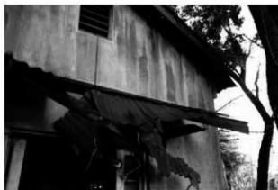
14 庇の破損状況写真
