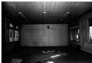
32 同31 作業室の南西桁行方向を見る 間仕切りは後世の改造
