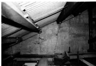
37 間仕切り壁および妻壁は屋根面まで達してトラスを省いている
