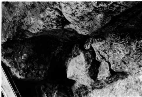
2. 隧道側壁陥没状態 (西から)
