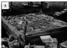
6 表面に発泡ウレタン樹脂を流し込み、さらに頑丈に固定する。発泡ウレタンの節約のため、ビニール袋等で風船をつくり、つめる。発泡が始まったら板等で圧力をかけ平らにする。 薬劑：ハイブロックス（主劑・硬化劑）主劑 對硬化劑=1對1
