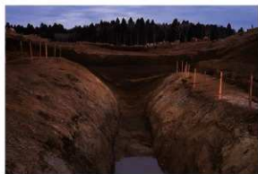
堀跡に堆積した土砂の様子
