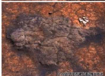
D:22区,不定形残北面2楼出状况
