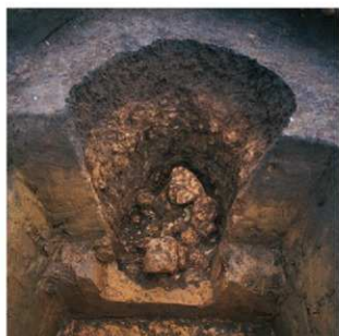
底部付近の土塊
