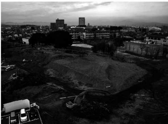
(1) 平成 24 年恵解山古墳保存整備工事その 2 竹樹木伐採状況全景 (南西から)
