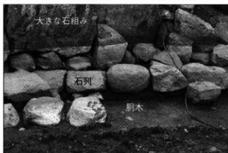
春風埦東側の護岸（詳細） 大きな石組みや築山が造成される箇所には、石列の下にも胴木を置いて補強している。
