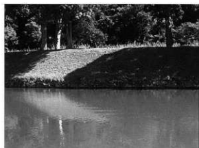
写真83 修理前 (内堀沿い修理石垣No.14)
