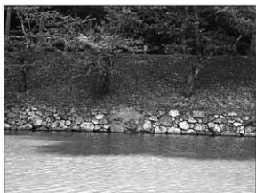
写真84 修理前（内堀沿い修理石垣No.10）
