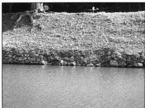
写真76 修理前（内堀沿い修理石垣No.6）
