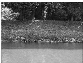
写真78 修理前（内堀沿い修理石垣No.7）
