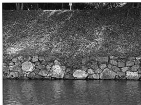
写真80 修理前（内堀沿い修理石垣No.8）
