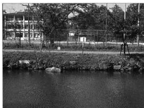
写真86 修理前（内堀沿い修理石垣No.11）
