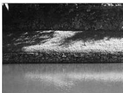
写真89 修理前 (内堀沿い修理石垣No.12)
