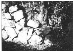
写真45 修理前（第2面中央付近）
