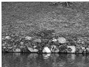
写真82 修理前（内堀沿い修理石垣No.9）
