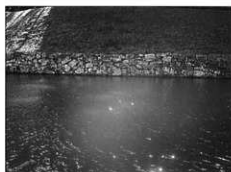
写真70 修理前(内堀沿い修理石垣No.3)
