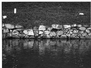
写真72 修理前（内堤沿い修理石垣No.4）
