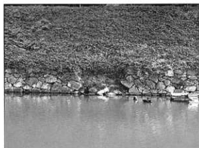
写真74 修理前（内堤沿い修理石垣No.5）
