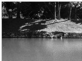
写真91 修理前 (内堀沿い修理石垣No.13)
