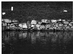
写真72 修理前（内堀沿い修理石垣No.4）
