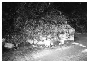
写真29 修理前 (御門石垣第1面)
