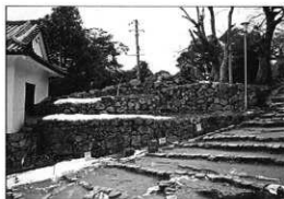
写真62 修理前（正面から撮影）
