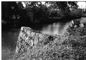
写真17 修理前 (米蔵水門石垣第3面)
