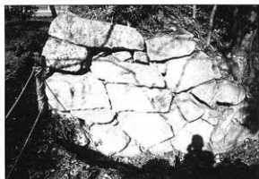
写真43 修理前 (第2面南侧)
