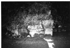
写真27 修理前 (御門石垣第1面)
