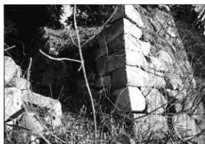
写真19 修理前 (米蔵水門石垣第1・5面)
