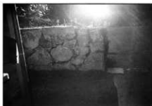
写真25 修理前(御門石垣第4面)
