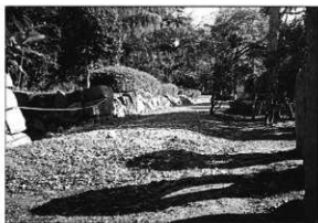
写真50 修理前 (第3面、西から撮影)
