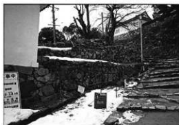
写真64 修理前（東から撮影）
