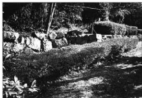
写真39 修理前（正面から撮影）
