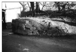
写真33 修理前 (御門石垣第3面)
