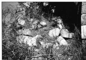
写真21 修理前 (米蔵水門石垣第2・6面)
