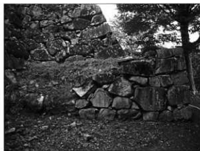
写真130 修理前 (石垣No19)
