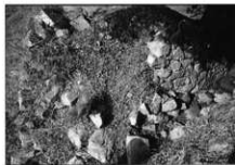
写真13 修理前(米蔵水門石垣第2・6面)
