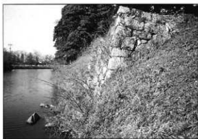
写真15 修理前 (米蔵水門石垣第3面)
