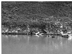
写真74 修理前（内堀沿い修理石垣No.5）
