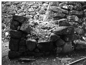
写真128 修理前 (石垣No18)
