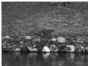
写真82 修理前（内堀沿い修理石垣No.9）
