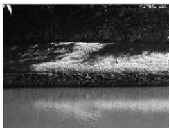
写真89 修理前 (内堀沿い修理石垣No.12)
