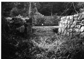
写真56 修理前 (背面から撮影)
