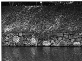
写真80 修理前（内堀沿い修理石垣No.8）
