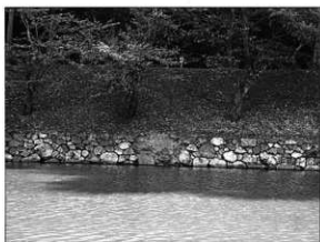
写真84 修理前（内堀沿い修理石垣No.10）
