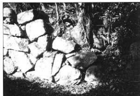
写真45 修理前 (第2面中央付近)
