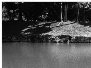
写真91 修理前 (内堀沿い修理石垣No.13)
