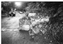
写真23 修理前(御門石垣第2面)
