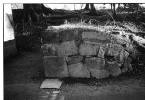
写真31 修理前 (御門石垣第3面)
