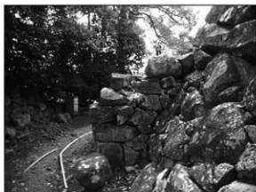
写真126 修理前 (石垣No18-1)
