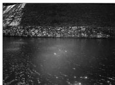
写真70 修理前（内堀沿い修理石垣No.3）
