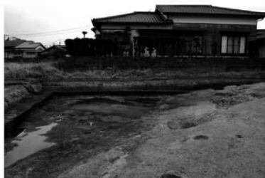
3) 谷落ち肩状況（北から）
