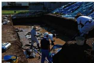
第2調査地点湧水発生状況
