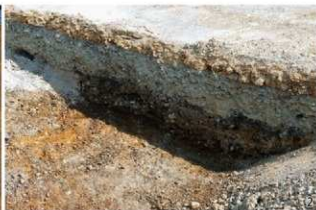
1 8トレンチ 断面全体 (南西より) 2 8トレンチ Y断面 (北西より)
