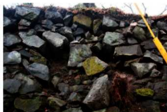
写真11 9面築石欠落部2
