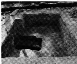
第34図 鏡池東岸の若草伽藍北櫓列の掘り方(東から)233トレンチ
