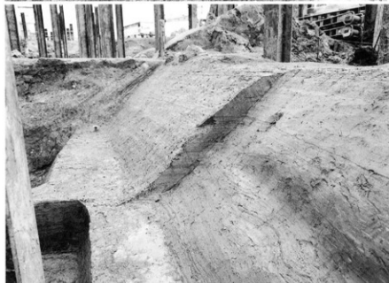
東側法面の段差 (堀 83：南から)
