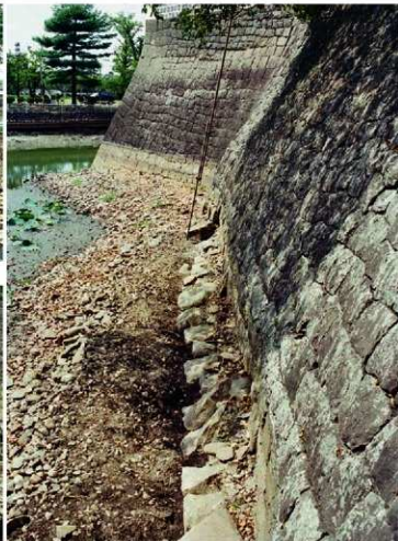
Eトレンチ内 石垣下端の変形 (E・F面：東から)
