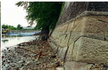
旧二の丸隅櫓南西面下 石垣変形②下端拡大 (G面：南東から)
