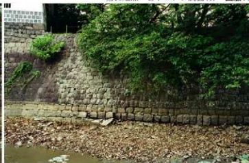
Eトレンチ西端 石垣下端の変形 (E面：南から)
