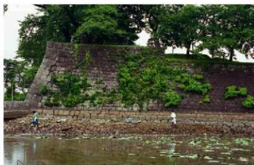
三階櫓南西面下 石垣変形③ (K面: 南西から)
