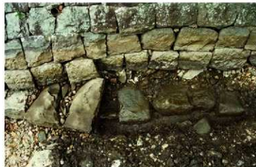
石垣下端の変形と土管理設 (E面：西から)
