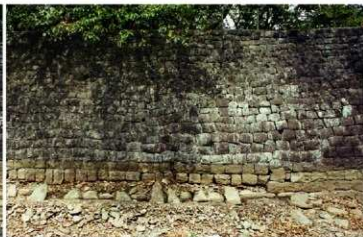
石垣下端の変形と上部積み直し状況 (E面：東側)
