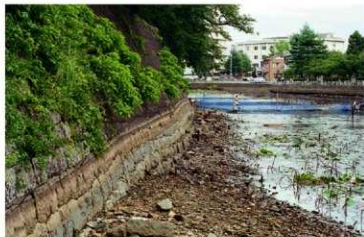
三階櫓南西面下 石垣変形③ (K面: 北西から)
