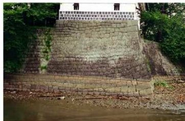
旧二の丸隅櫓南西面下 石垣変形② (G面：南西から)
