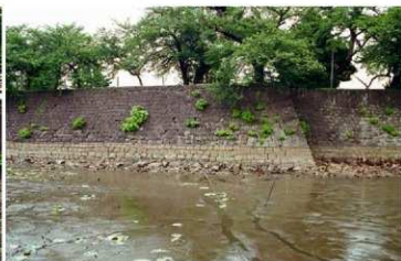
北側折南脇 石垣変形③・補強④ (K面: 南西から)
