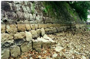
石垣下端の変形と土管埋設 (E面：西から)
