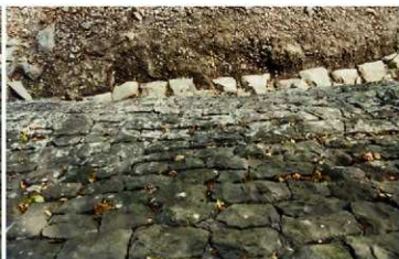
石垣下端変形①と上部積み直し部 (E面：東端，南上から)
