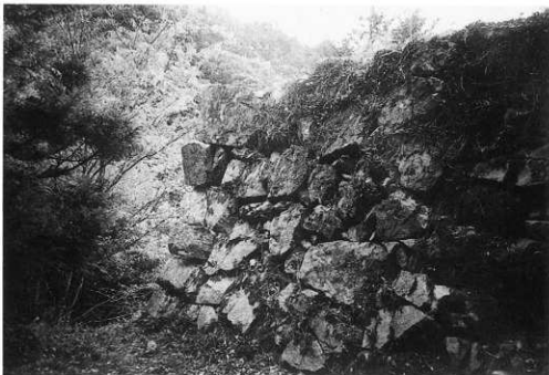
石垣破損状況（東から）
