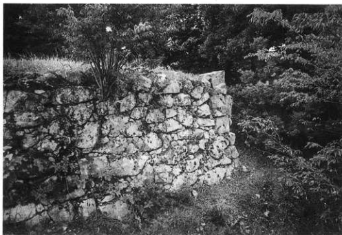
石垣破損状況（南から）
