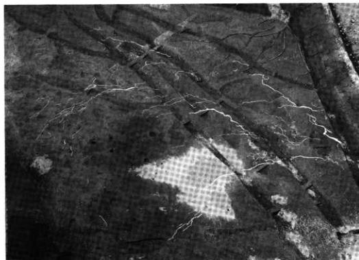
(2) 第二進構面 地震による亀裂
