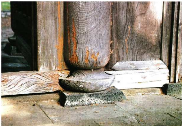
九代廟門柱(腐朽)
