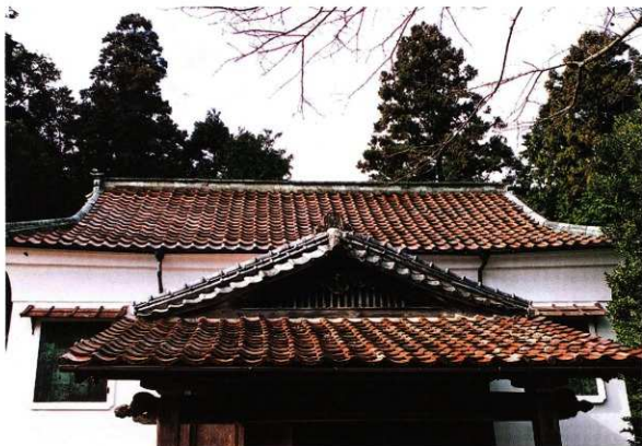
御霊屋屋根(陥没あり)
