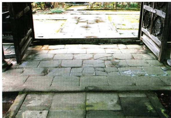
三代廟門内石敷(破損)
