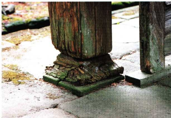
二代廟門柱足元(腐朽)
