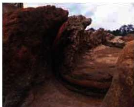
SY01 断割りセクション3(燃焼室付近)
