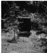
分電盤の設置状況
