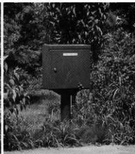
イベント用コンセント盤 設置状況
