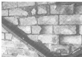
写真-215 煉瓦劣化状況
