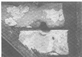
写真-164 水平連結棒の露出状況
