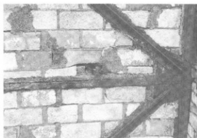
写真-218 煉瓦劣化状況（空隙部に蛇が侵入）
