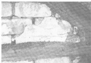
写真-173 漆喰残存状況（南炉西面）
