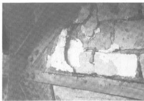
写真-172 漆喰残存状況（北炉西面）
