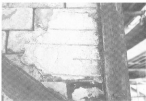
写真-174 漆喰残存状況（南炉東面）
