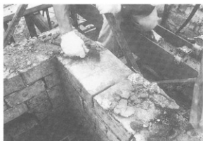
写真-166 煉瓦目地 (水平方向)
