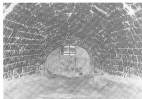
写真-150 炉内（南B炉湯口側）
