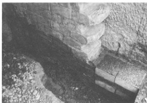
写真-143 下焚口(赤煉瓦補修) 南A炉において下部に赤煉瓦で補修がされている
