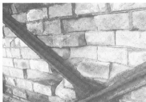
写真-214 煉瓦劣化状況
