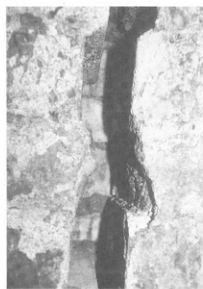
写真-105 煙突内部亀裂補修前
