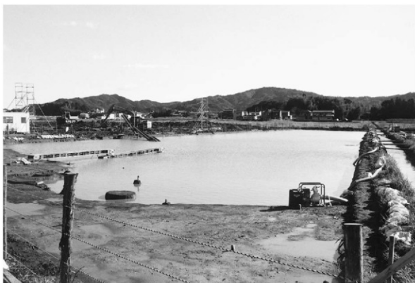
1C区冠水状況（北より）
