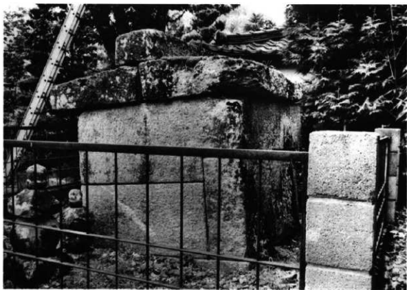
7 修理前 背面(北東面)
