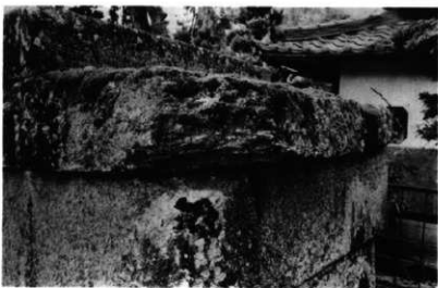
18 屋根石風蝕（背面）
