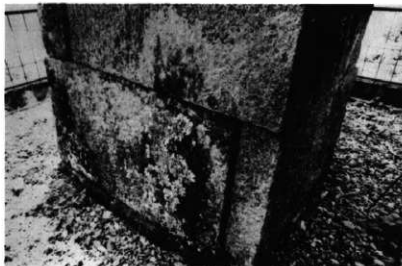
15 壁石のすれ（背面）
