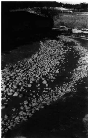
後円部南東側礫石崩落状況①（南から）
