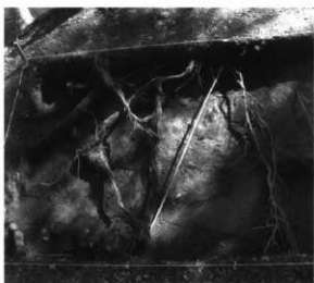
11 1-5区水道管、桜の根の状況(北から)
