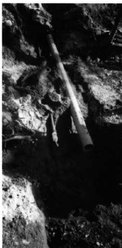
管路第1トレンチ配石No.1 (砂入れ後污水管は遺構上を通す)
