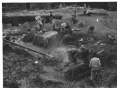
破烈した排水管
