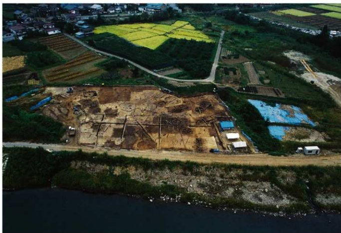
1. 8区全景（南東千曲川上空から）右側は9区、後方はJR飯山線替佐駅
