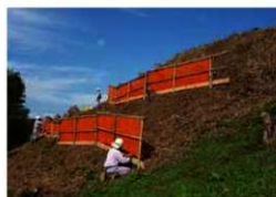
調査前に設置した転落防止柵
