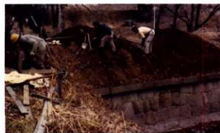
昭和 51 (1976) 国補重要文化財等保存整備工事 ⑨通用門土塁土盛工事
