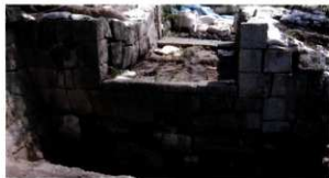
六門排水口B面：修理前で石垣が孕んでいる。
