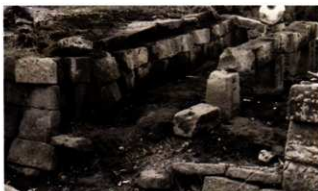
昭和 51 (1976) 重要文化財等保存整備工事 ⑦黒門石橋架替 解体中
