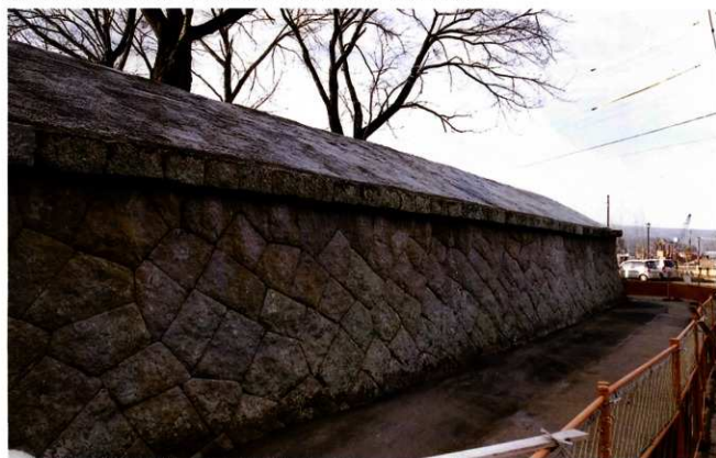
黒門西側石垣解体修理後 石垣西側全景（北西より） H22.12撮影
