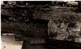
昭和 49.8.26 台風通過に伴う④崩壊ヶ所 (大手橋付近)
