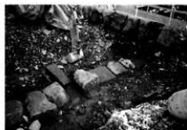
石組み暗渠内には泥土が充填
