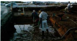
'02年10月 H93調査風景 常時排水しても水溜りのまま
