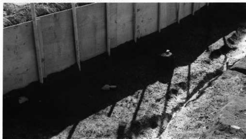
T a 1号竖穴状遺構 未調査区域の北側全景 南西より
