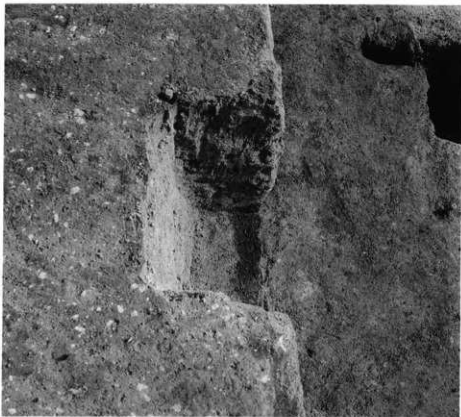
H1号住居址 地盤のズレによる北壁の状態
