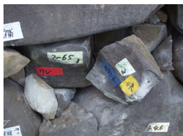
石材破損（補強）
