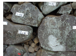
内部流出（栗石・詰石補充）
