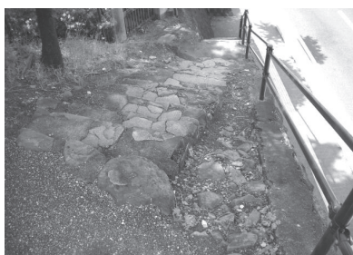
写7-1-3 復旧前の状況
