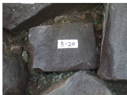
詰石欠落（詰石補充）
