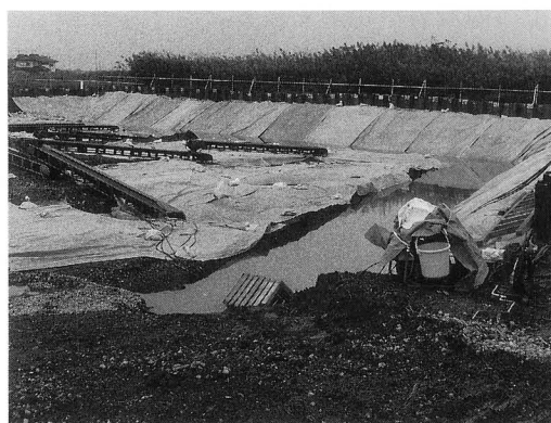
II区 降雨・涌水による調査区水没状況
