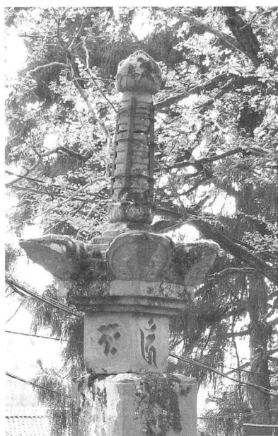
相輪の折れの補強状況（修復前）
