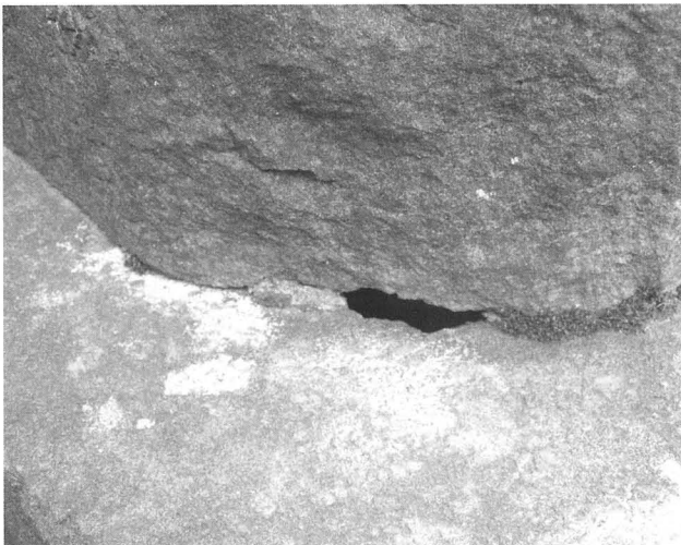
基壇2段目 中空状況
