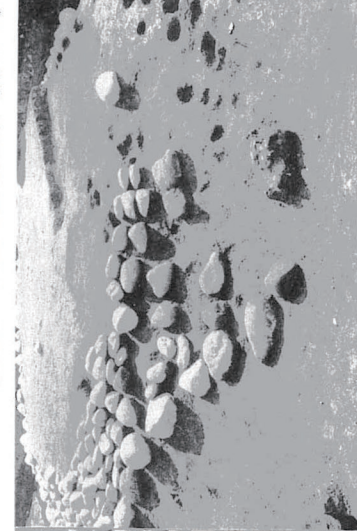
写真20 A区 SZ01葦石崩落状況
