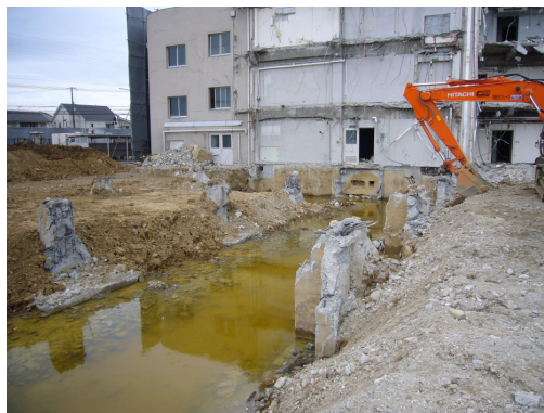
②4/21 水がたまるとまるでプールのようです。
