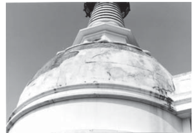
第2次保存修理前 塔身上部破損状況
