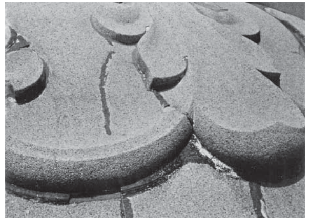
第1次保存修理前 劣化状況
