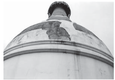
第2次保存修理前 塔身上部破損状況
