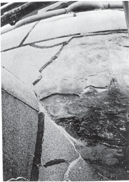
第 1 次保存修理前 劣化状況
