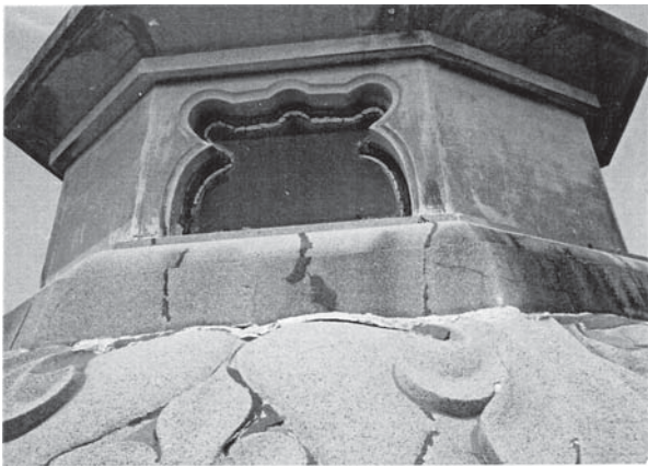
第1次保存修理前 劣化状況
