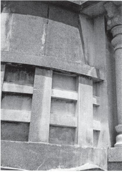
第 1 次保存修理前 劣化状況
