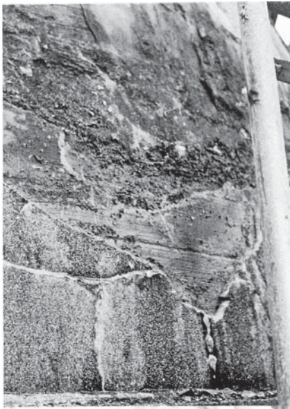
第 1 次保存修理前 劣化状況
