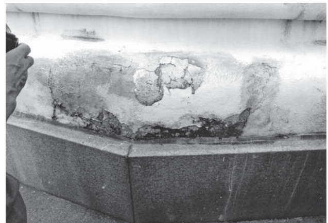
第2次保存修理前 塔身下部破損状況
