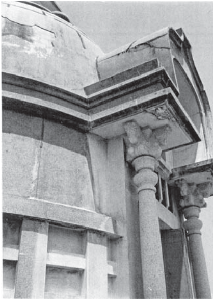
第 1 次保存修理前 劣化状況
