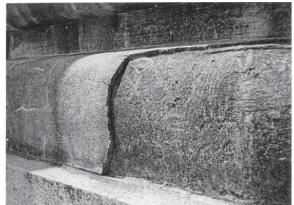
第1次保存修理前 劣化状況
