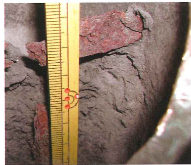
写真 54 内部 筭 内底部より約 12 cm の所に筭がある
