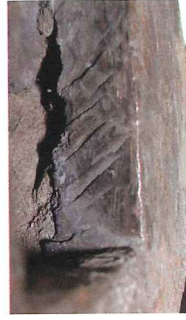
写真 17 ホゾ孔 左側側壁 はつり痕
