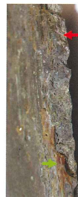
写真 49 写真 48 の黒矢印 部分の断面
