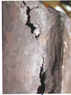
写真 16 ホゾ孔 底部亀裂
