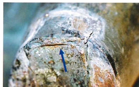
写真 97 ホゾ孔に挟まったホゾの端部
