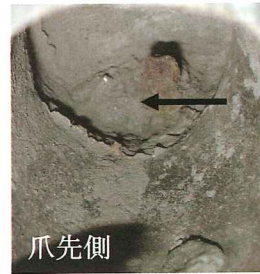
写真 57 内部 筋金を除去した後 金属に埋もれた筋金が残る
