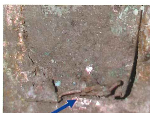
写真 73 ホゾ取り付け部分 の破断残片
