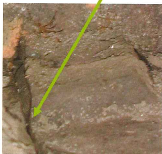
写真 25 体躯内 右体側部 接合面
