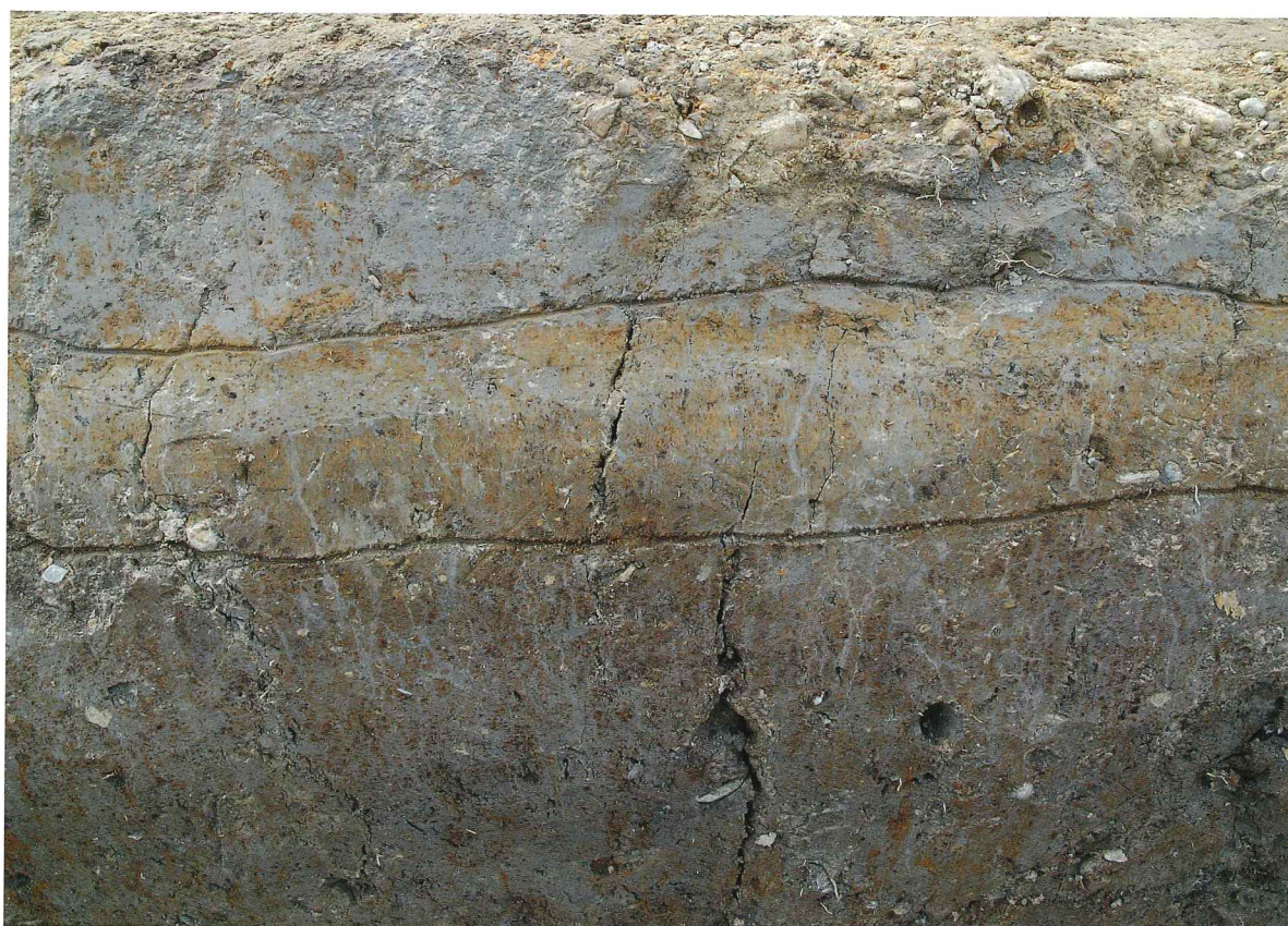
2 : 平成18年度 第3工区／調査区西壁・噴砂検出状況2 (東から)
