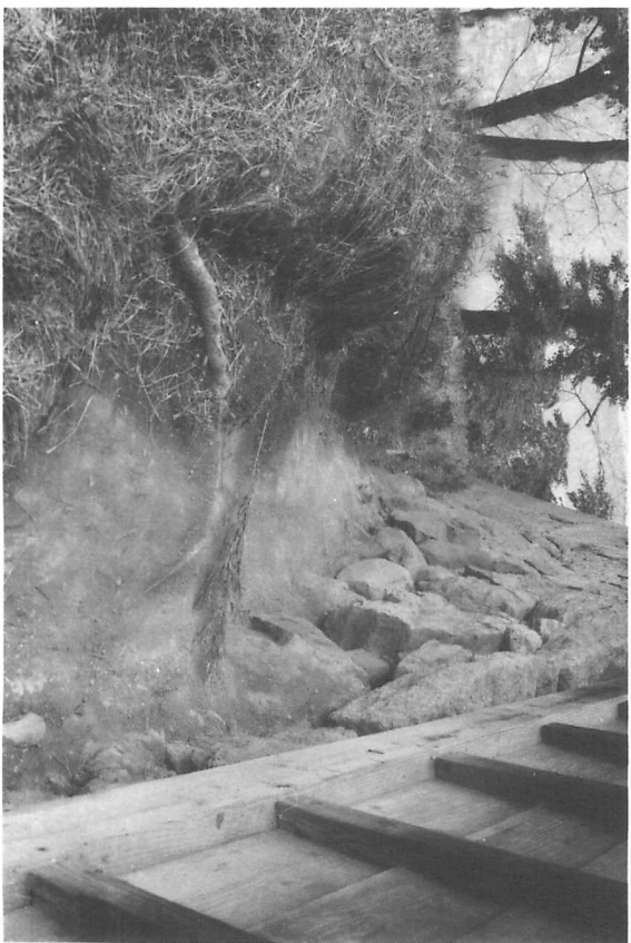
90 修理前 同上石垣脇土塁流失状態
