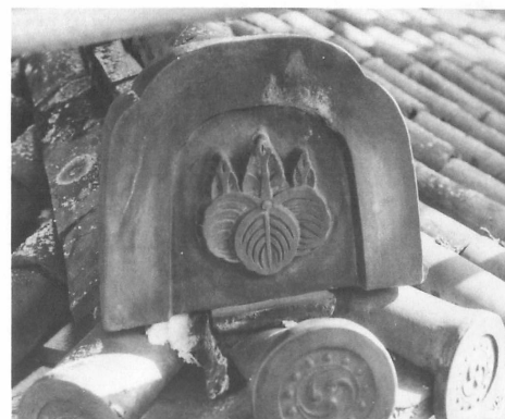
74 修理前 隅鬼瓦 昭和時
