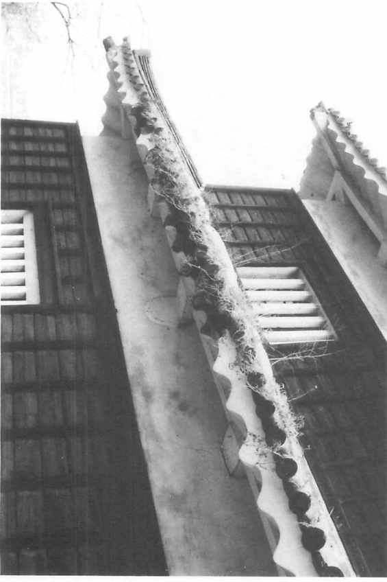
84 修理前 北面軒先破損状態
