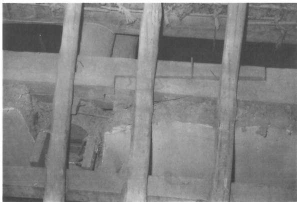
二階床梁の出桁受け跳出し部分が切断されているため、両面から板を打って支えている
