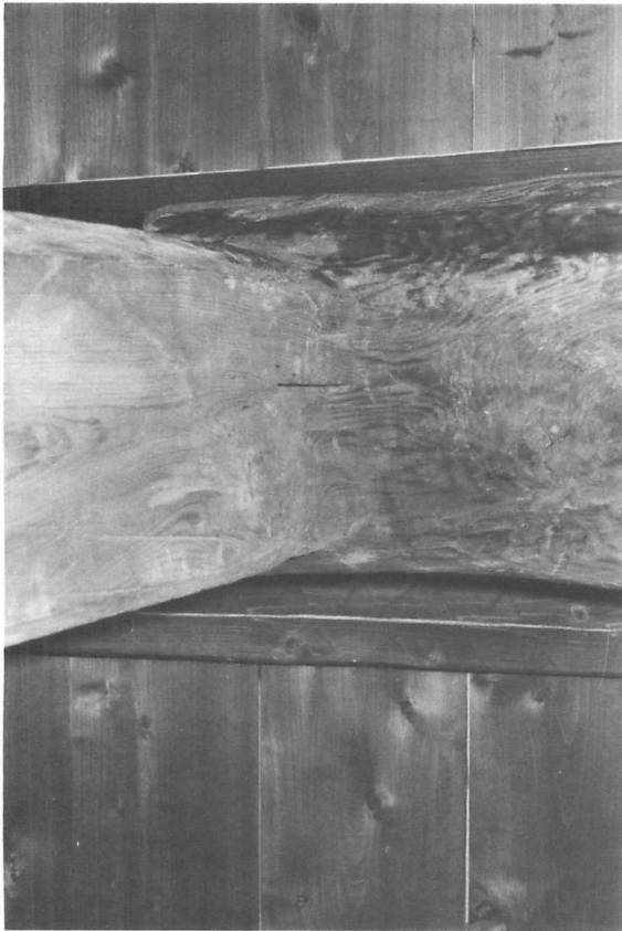
22 竣工 一階真柱上部二階梁当り痕
