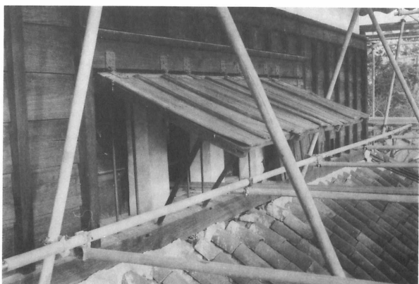
33 修理前 二階窓廻り状態
