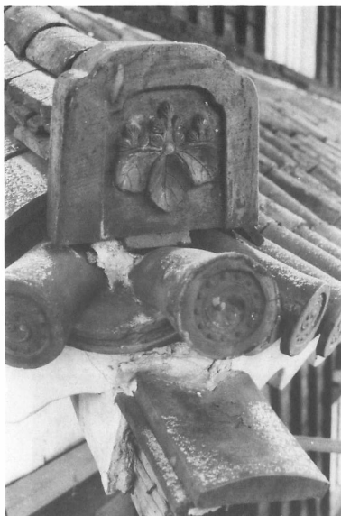
76 修理前 隅棟鬼瓦等現状
