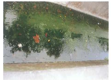
写真3-56 自浄作用が減じて汚れている
