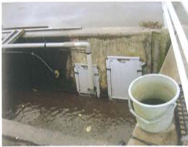
写真3-13 上井手: 塩ビ製の樋管
