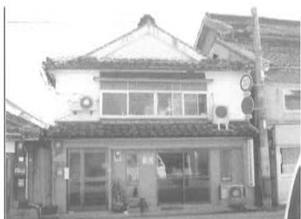
↑ 軒切りで一階ファサードを失った町家
