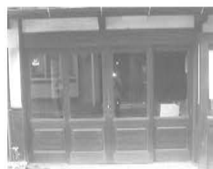
出入口 (ガラス戸引き違い)
