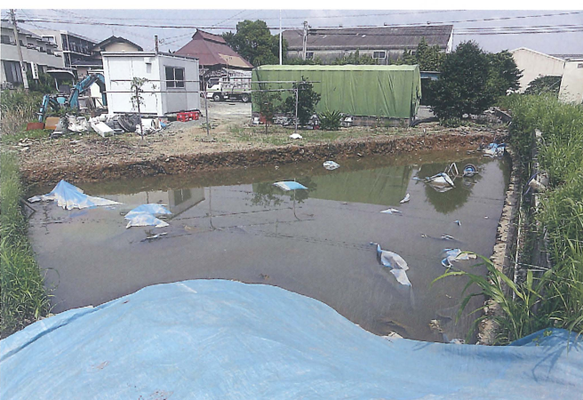
大雨による現場の水没（西より）
